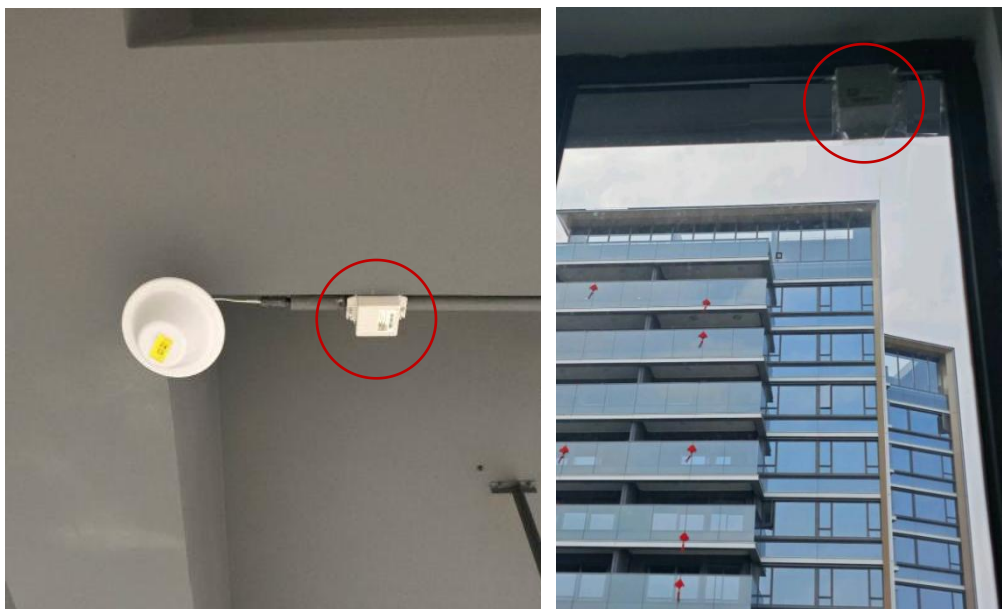
图4 监测终端安装位置
